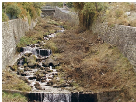
La ramaglia lasciata in alveo dopo un intervento di bonifica rappresenta uno dei maggiori elementi di pericolo in caso di piena (anche ordinaria)
